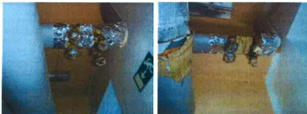
Obr. 7 – Stávající stoupačkové uzávěry a vypouštěcí kohouty DN 15
