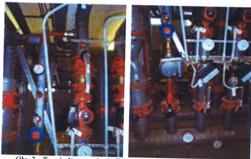
Obr. 2 – Topná větev označená „Tělesa“ v předávací stanici v budově „B“
