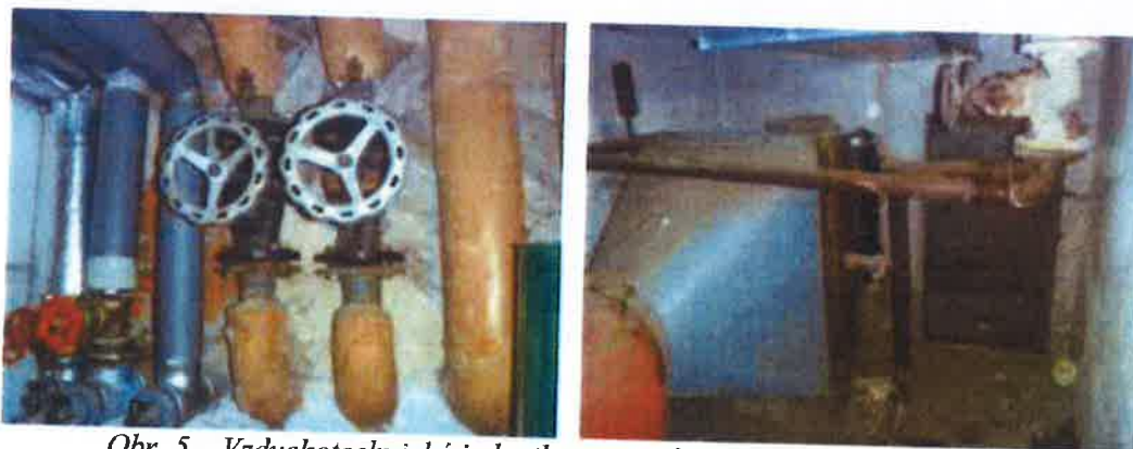
Obr. 5 – Vzduchotechnická jednotka pro vytápění kuchyně v budově „D“
